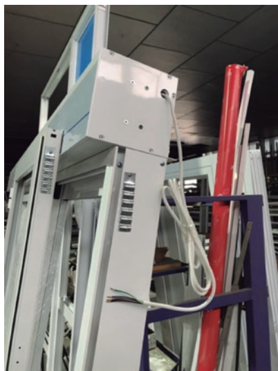
Figura 72. Salida del cableado del motor
